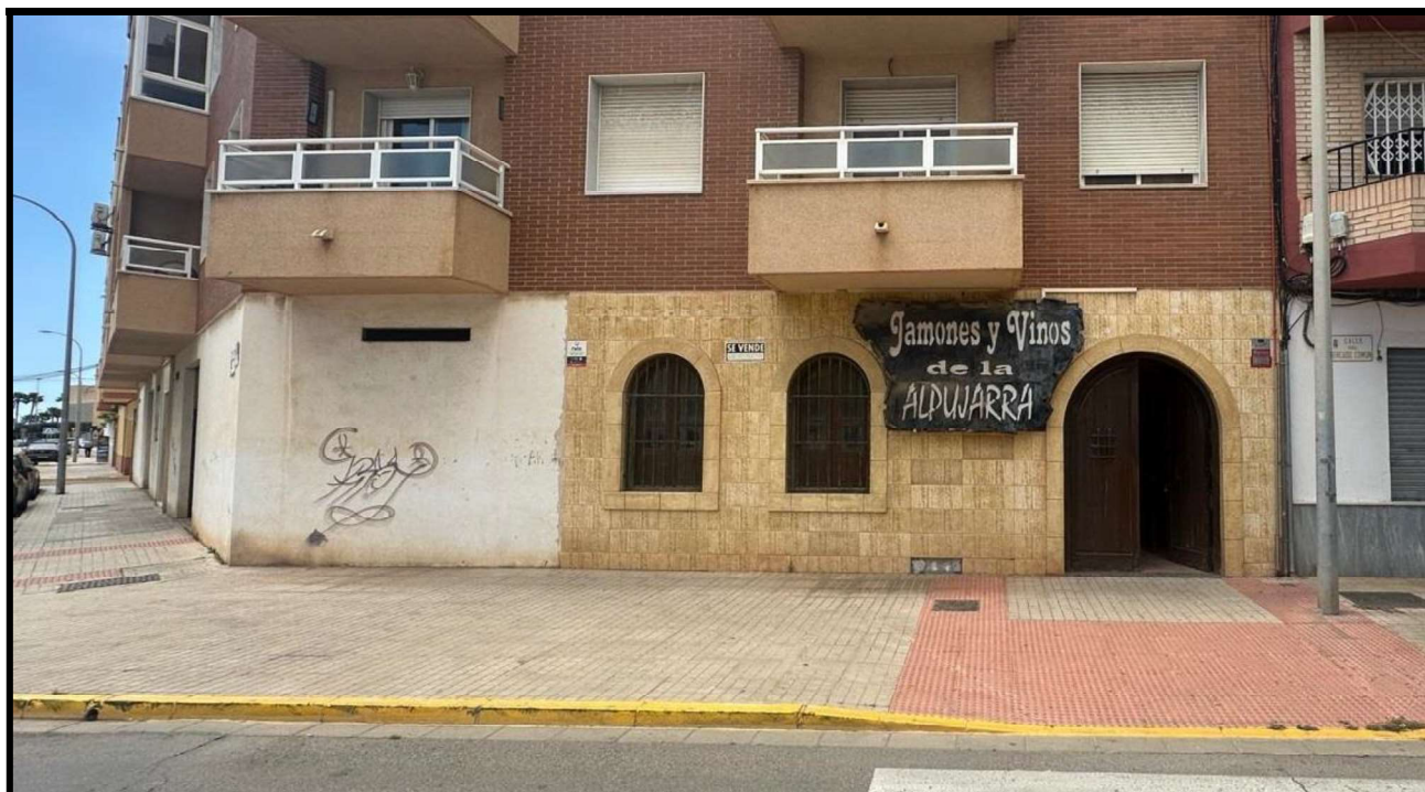
Fotografía estado inicial de la fachada del local
