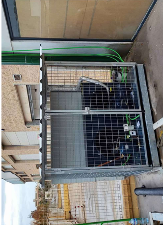
CASETA EQUIPO DE FRIO
