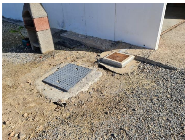
Arqueta de acometida a la nave
