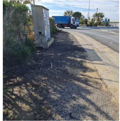
Armario de contador de agua desde donde sale la acometida de agua no potable
