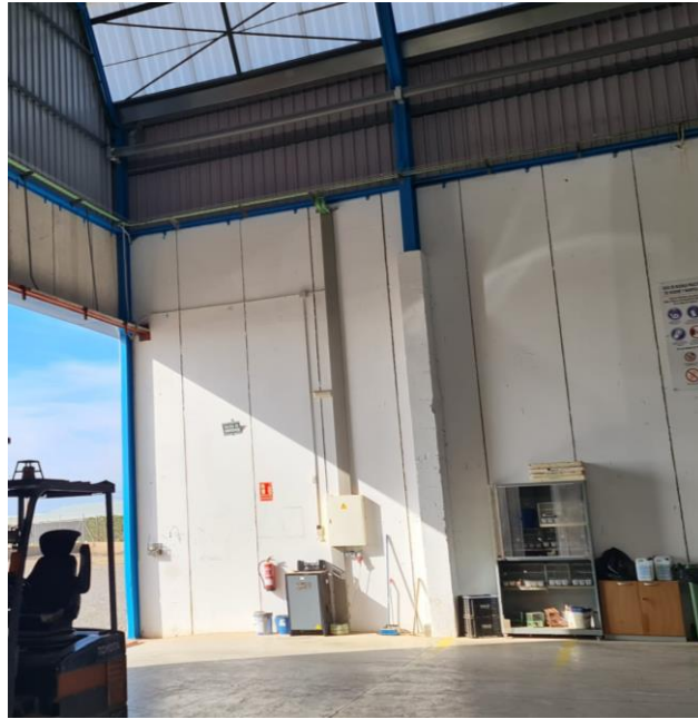
Cuadro eléctrico principal de la nave
