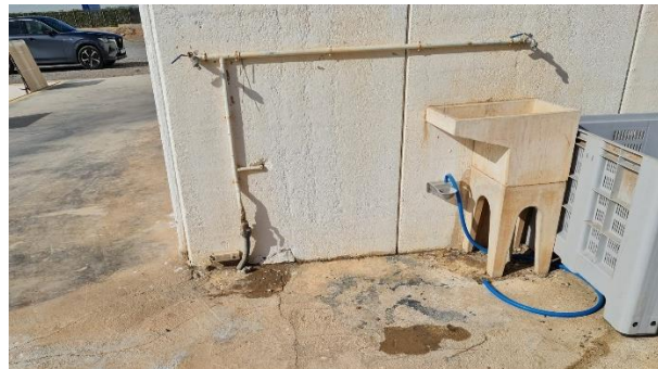
Grifo en exterior de nave
